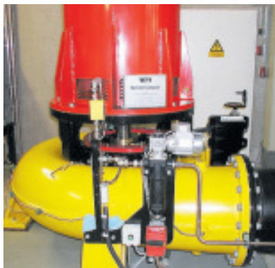
Die Francis-Turbine in der Wasserkraftanlage in Schönmünz.
